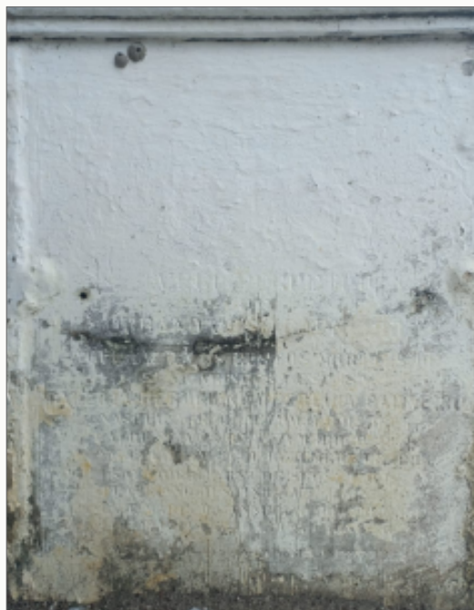
Figura 5: Lápide degradada por pintura
