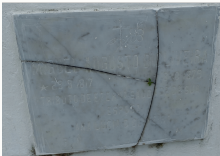
Figura 3: Lápide degradada por rachadura na qual nasceu uma planta
