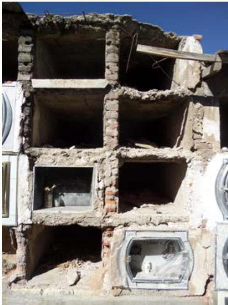
Figura 16. Estado de conservação de nicho no Cemeterio General de Oruro
